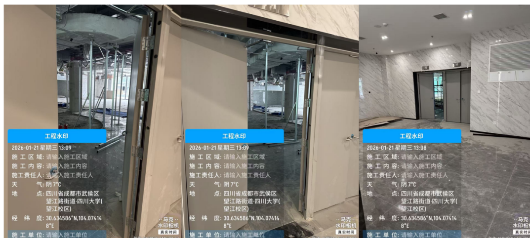
图3-18 2026 年 1 月 21 日下午 1 点拍摄，南楼 1 楼大堂情况
